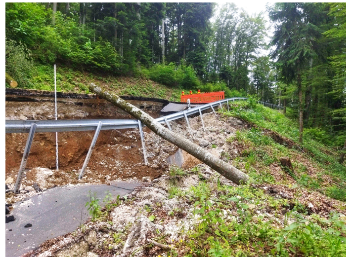
Abb. 2: Reaktivierter Bereich in einem bekannten Rutschhang an der Landesstraße L433a am Klippeneck bei Denkingen, Lkr. Tuttlingen
